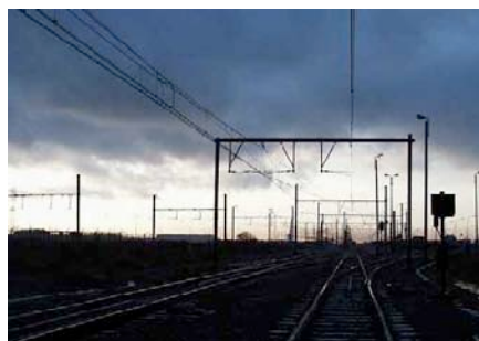
Portique caténaire – port de Zeebrugge
