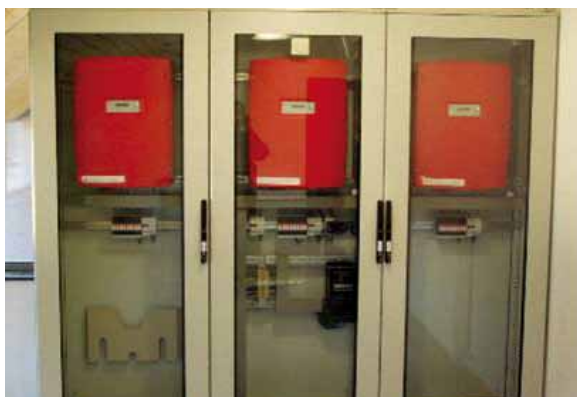
Trois onduleurs permettent de transformer le courant continu en courant alternatif
