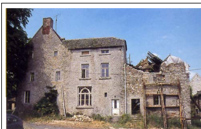
Etat de la ferme d'Omalus avant l'intervention
