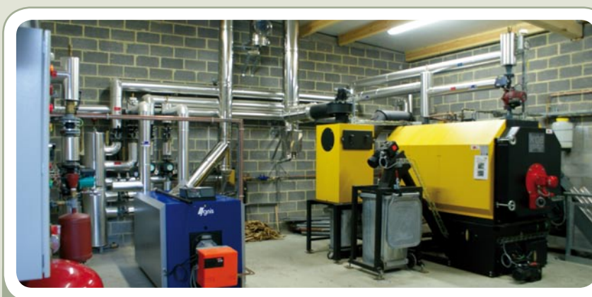
Sous-station d'un réseau de chaleur, avec les échangeurs de chaleur.
